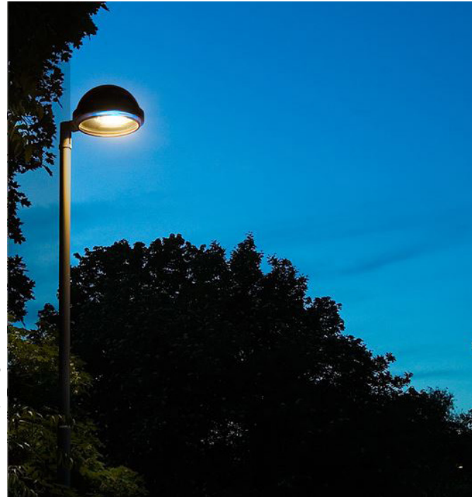
Exempel på belysning på en stolpe som kan lysa upp området och göra det tillgängligt även under dygnets mörka timmar.
